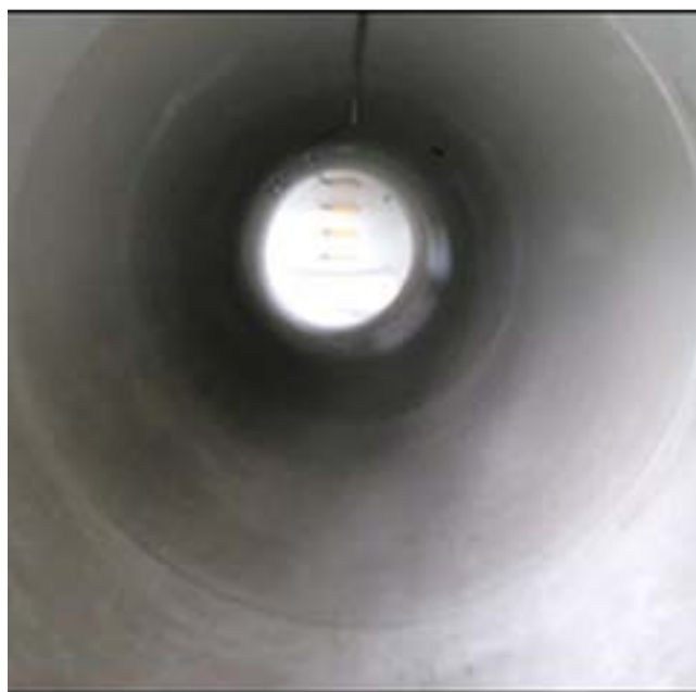
東京都下水道局より 正常な下水道管
