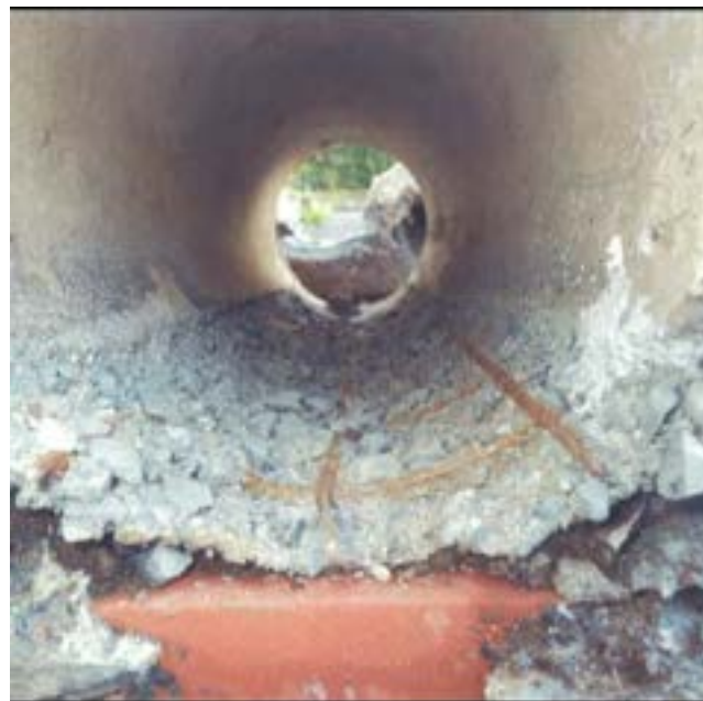
東京都下水道局より 酸性排水による破損した 下水道管
