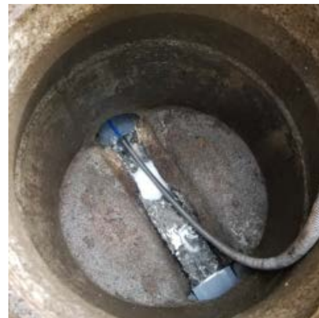
某透析病院下水道管直前 一部に破損が見られる
